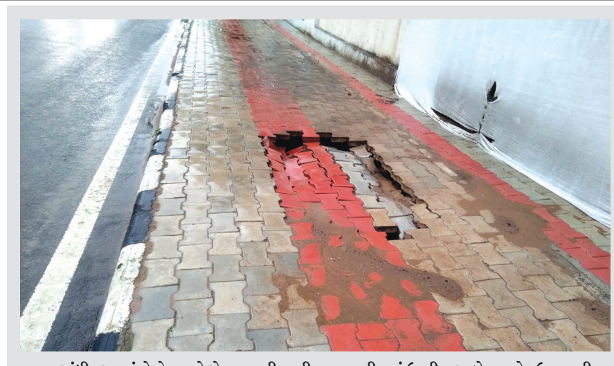
ગાંધીનગરમાં મેઘો જામ્યો છે. વરસાદી પાણી સતત જમીનમાં ઉતરી રહ્યા છે. ખ-રોડ ઉપર નવી જ બનાવેલી ફૂટપાથ ભારે વરસાદના કારણે બેસી ગઈ છે. ક્યાંક નબળી ગુણવત્તાના દર્શન પણ થઈ રહ્યા છે.
