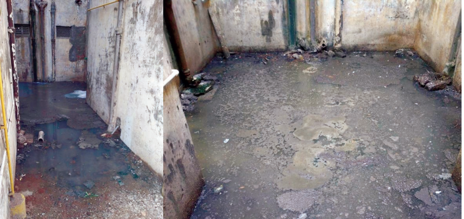
સેક્ટર-૨૫ જીઆઈડીસીમાં છેલ્લા ૩ મહિનાથી ગટરો ઉભરાતા સ્થાનિક રહીશો ત્રાહીમામ પોંકારી ઉઠ્યા છે. રહેણાંક વિસ્તારમાં આરસીએલ-ઈ બ્લોક પાસે ગટરનું દુષિત પાણી ઉભરાવવાથી મદબદતી ગંદકી વચ્ચે રહીશો ગુંગળામણ અનુભવી રહ્યા છે. ગંદકીને લીધે સ્થાનિક રહીશોમાં રોગચાળાની દહેશત પ્રવર્તે છે. ત્વરિત અસરથી આ સમસ્યાનું નિરાકરણ આવે તેવી માંગ ઉઠવા પામી છે.
